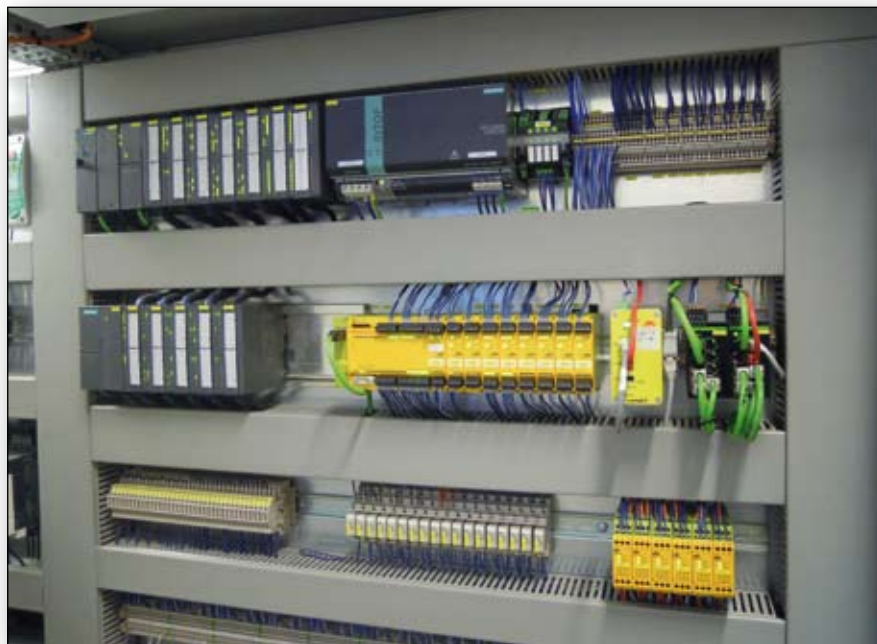
Afbeelding 5. Schakelkast van het pallettransportsysteem met de PNOZmulti veiligheidsPLC, I/O- en communicatiemodules. Onder zitten zes veiligheidsrelais voor de noodstop- en machinestopsignalen van de drie palletiseermachines.
