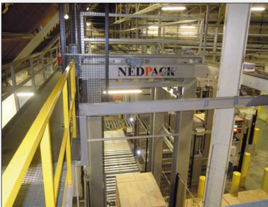
Afbeelding 4. Blik vanaf het bordes naar beneden waar juist een pallet vanuit de palletiseermachine op het pallettransportsysteem wordt geplaatst.
